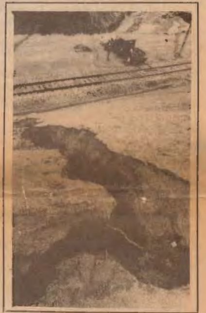
Uno de los factores que favorecen la erosión en el terraplén es la calidad del terreno, constituido por material arenoso, fácilmente desplazable por el agua. Algunas de las grietas tienen un metro de profundidad con un ancho de 30 a 40 centímetros.
